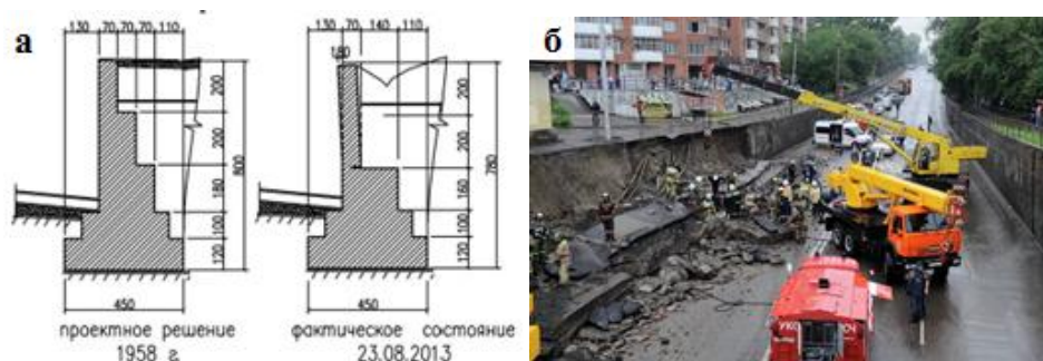
Рисунок 2 – Разрушение подпорной стены на проспекте Свободный
