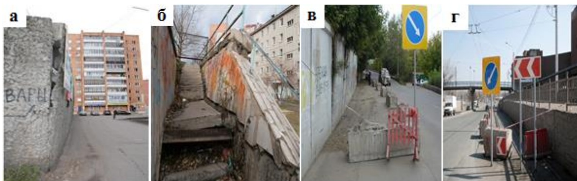
Рисунок 3 – Подпорные стены, находящиеся в аварийном состоянии
